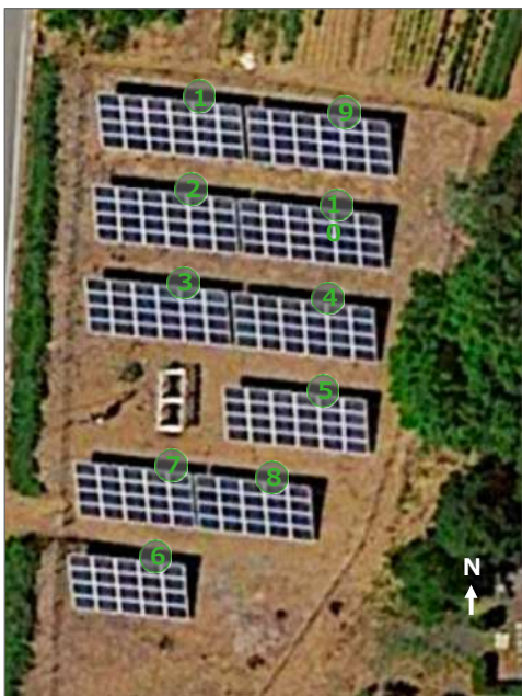
59 kW 野立ての航空写真 数字はインバーターの番号
