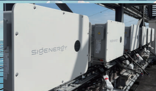
600 kWp PV容量 1.5 MWh 蓄電容量
