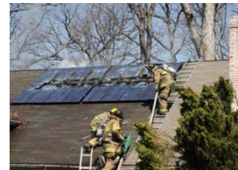
現場検証時の感電
