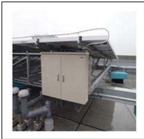
写真2-3 接続箱（PVモジュール下）
