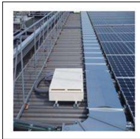
写真2-4 接続箱（PVモジュール横）
