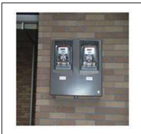
写真2-5 買電・売電用積算電力量計
