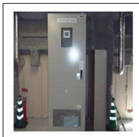
写真 2-2 パワコン (屋内)
