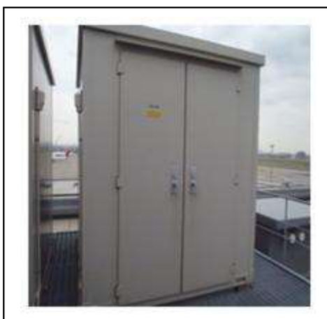
写真 2-1 パワコン (屋外)
